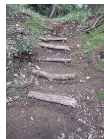
鉄パイプのみ残っていた 近くに落ちていた倒木を利用し 階段に作り直した
